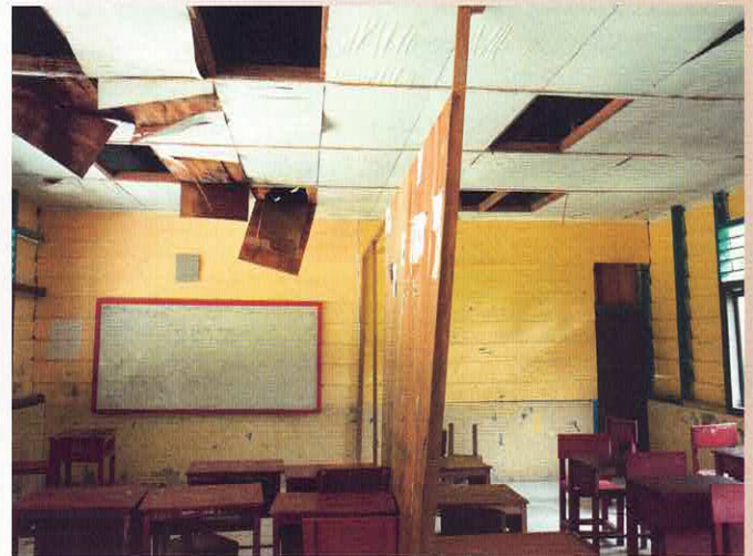
Renovierungsbedürftige Grundschule in Matuptuman
